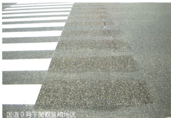
国道9号下関観音崎地区 抹消状況
